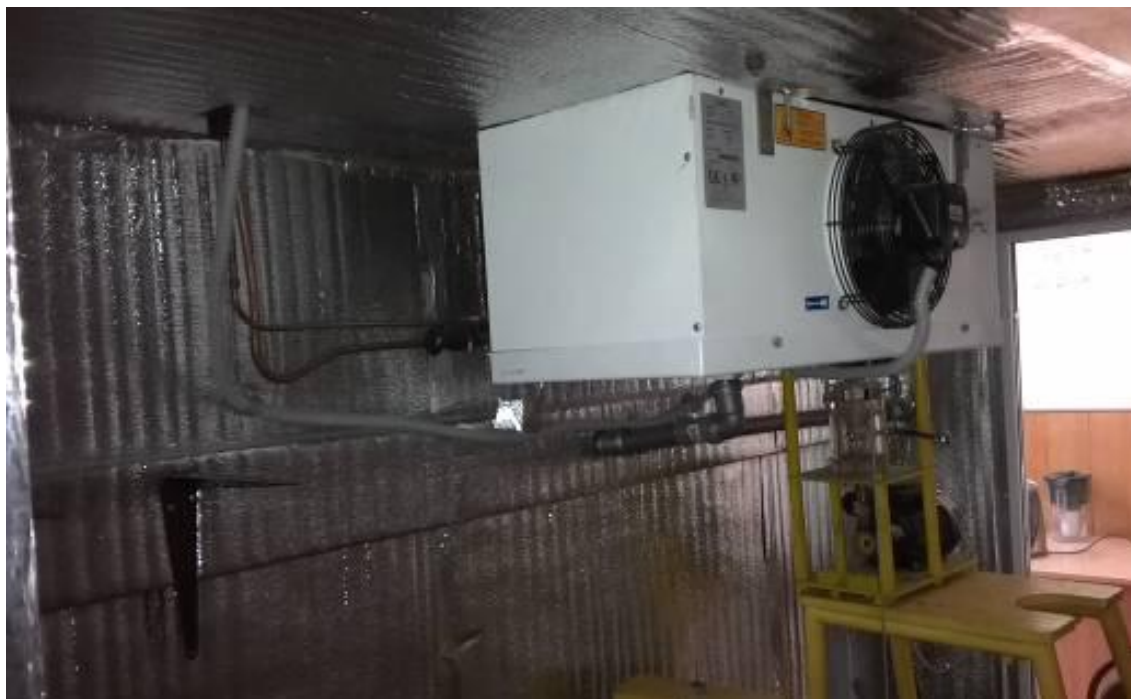
Рисунок 1.5 – Фото морозильной камеры №1
